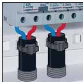
7 SUPORTES PARA FIXAÇÃO DOS CABOS POR BRAÇADEIRAS Permite otimizar a organização dos cabos.
